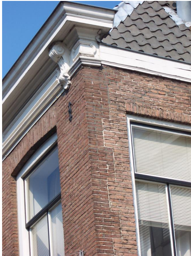
Afbeelding 2: detail aansluiting jongere voorgevel op oudere zijgevel doormiddel van bloktanden. Let op de verschillende baksteenformaten en de hoogte van de lagen
